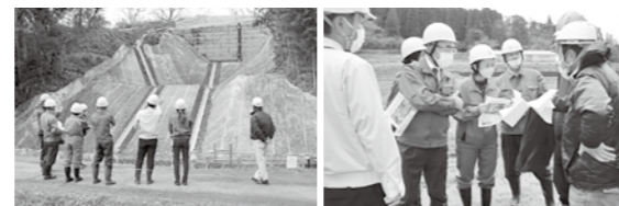
上米公園の復旧工事現場① 上米公園の復旧工事現場②
