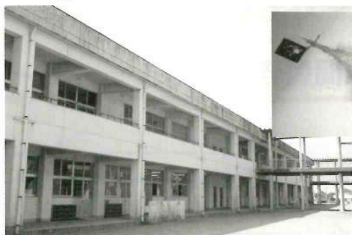
中学校南側校舎全体雨漏り
