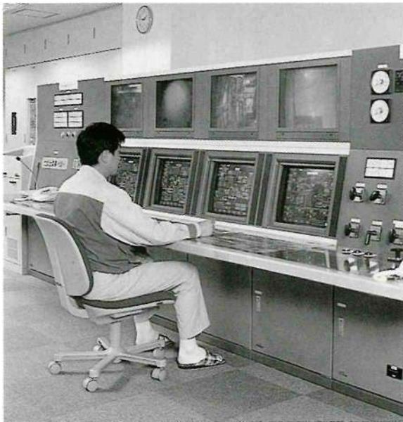
▲ごみ溶融処理施設の中央制御室
