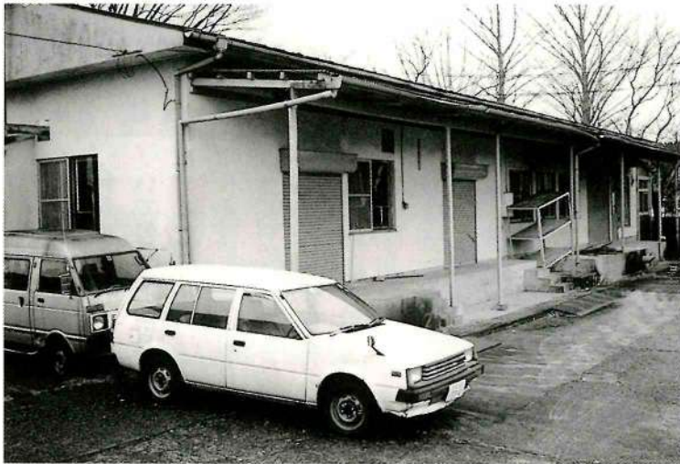
▲数台の車が放置しており、荒れ放題の旧給食センター
