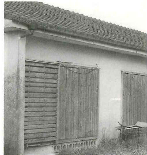
老朽化し、空屋の目立つ町営住宅
