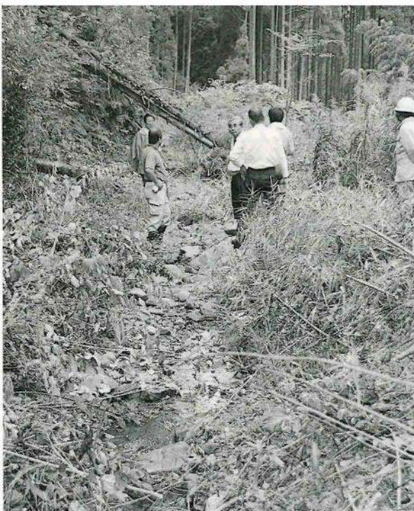
林道の災害現場の視察
