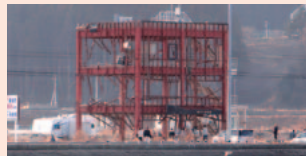
被災した防災庁舎
