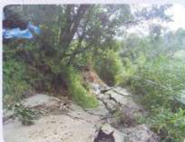
雨で崩壊した上米公園の園路
