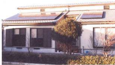
▶屋根の上に取り付けられた、一般家庭用の太陽光発電 (4㎡?)
