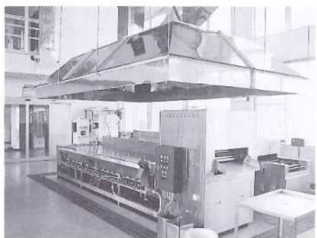
▲センター内の調理用機械
