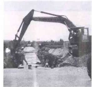
道路に埋設される下水路
